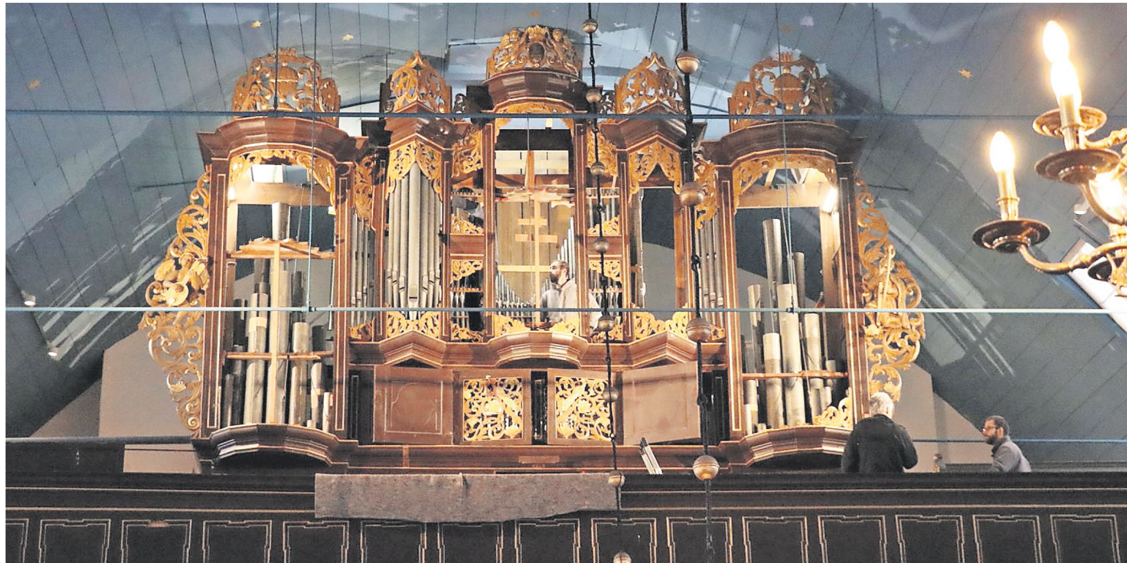
Die Lücken werden immer größer: Nach und nach, Pfeife für Pfeife wird die Otterndorfer Gloger-Orgel auseinandergebaut. Die Demontage des altherwürdigen Instruments wird wohl noch bis nächste Woche Donnerstag andauern. Fotos: Mangels
